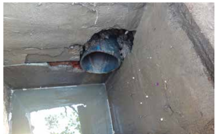
小河路与花园岗街交叉口的管道口
