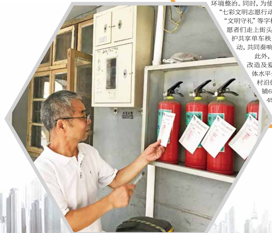
“文明城市创建市民督查团”成员在仓基新村社区检查灭火器设备。
