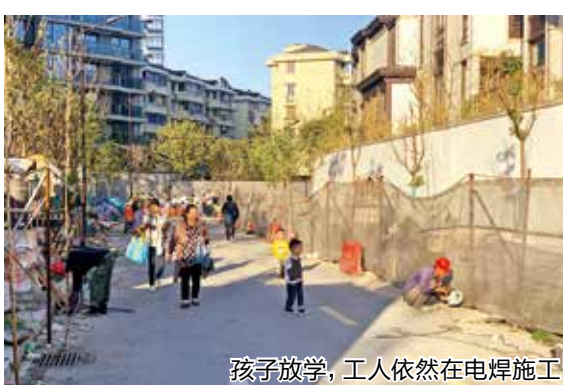
“工地”内部一侧并未有效设置围挡
