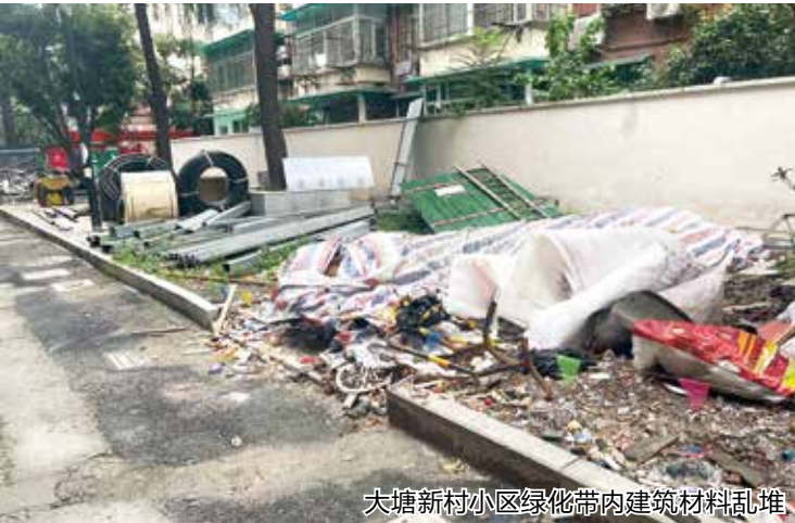
大塘新村小区绿化带内建筑材料乱堆
